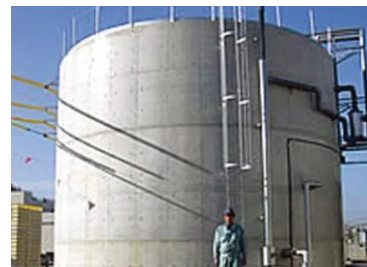
バイオマス燃料製造設備
