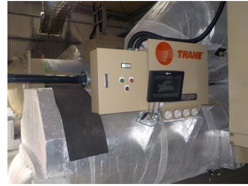
本社工場 高効率冷凍機
