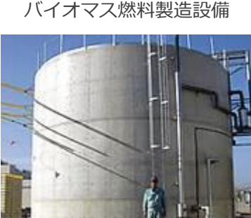
バイオマス燃料製造設備
